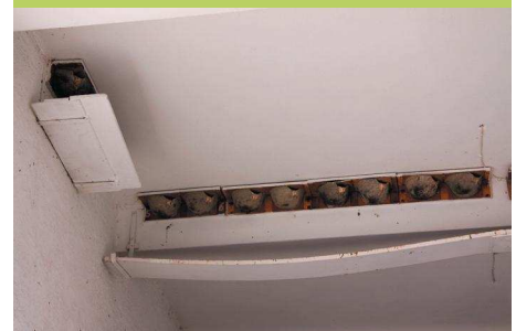
Schwalbennester über Toreinfahrt
